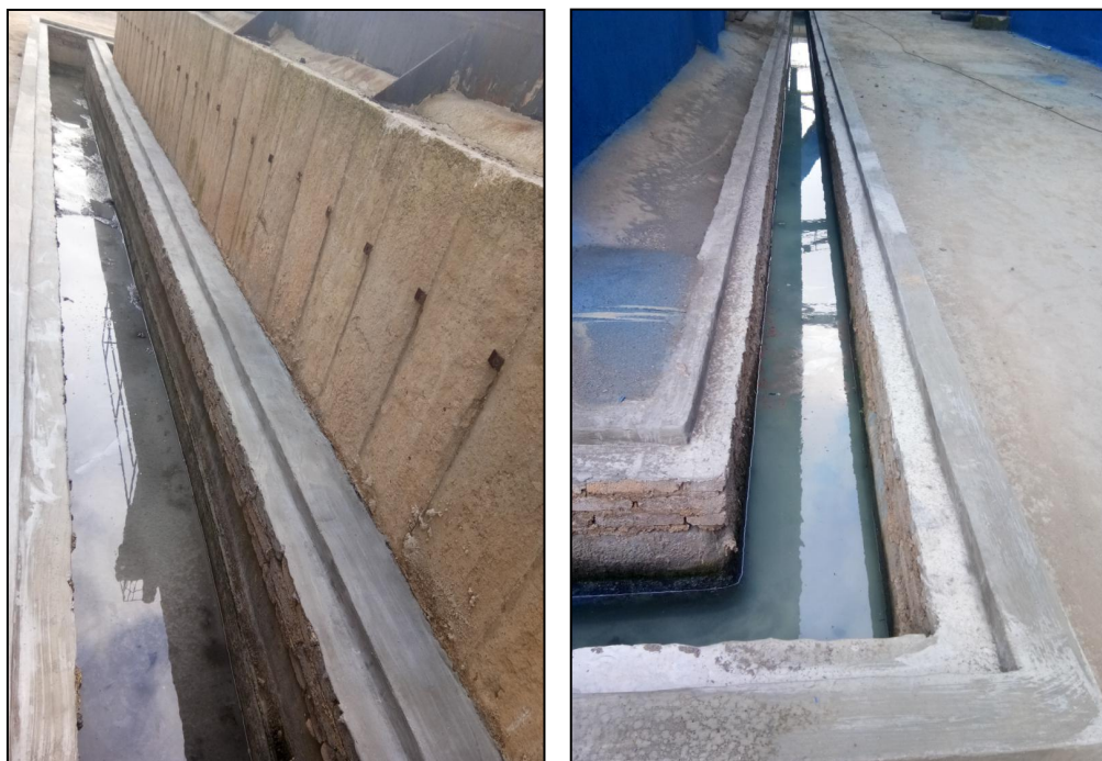
污水沟整改前现状图
