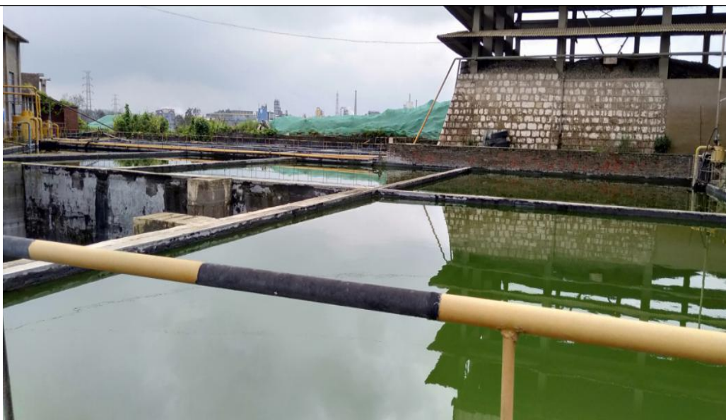
折流池整改前现状图
