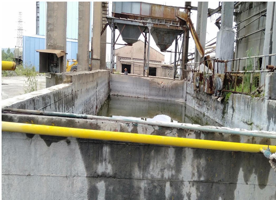
水淬渣池现场照片
